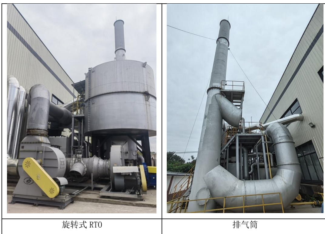
图 3-6 废气处理设施
