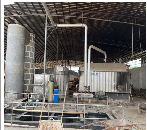
锅炉及配套的麻石水墨除尘装置
