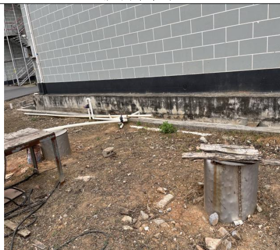
地下事故应急罐
