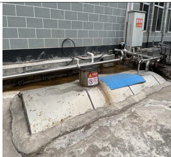
三级调节沉淀池
